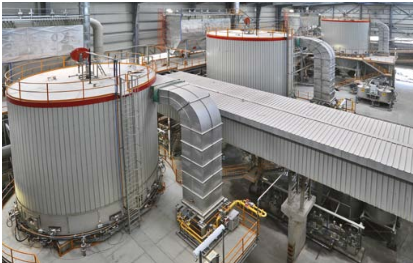
Florim Ceramiche - Stabilimento Via Canaletto (Fiorano Modenese, MO)
